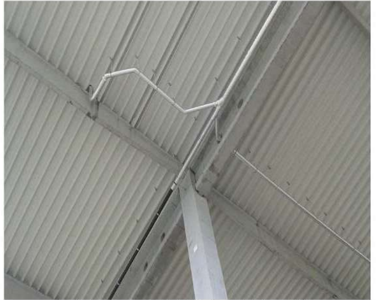
Podtlakové odvodnění střech: - CTP Nový Jičín
