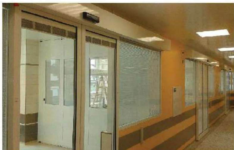
FN Plzeň - rekonstrukce ARK - křídla posuvných automatických dveří
