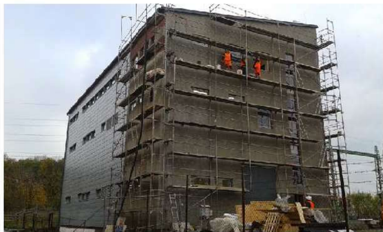
Kazetová ocelová fasáda. el. rozvodna Třeboradice - 900m 2
